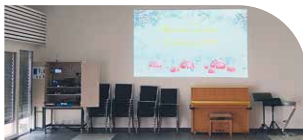
La nouvelle installation technique du centre paroissial.
